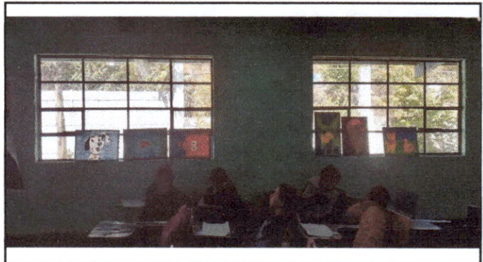
Foto 4: se cuenta ya con las ventanas nuevas mejorando la ventilacion de los estudiantes
